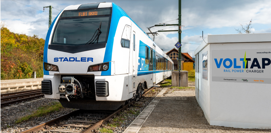
Die Schnellladestation VOLTAP besteht aus der Trafostation (Vordergrund) und einer Oberleitungsanlage (OLA) mit Lademasten und Ladeschiene.
