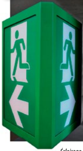
Éclairage de secours et de sécurité dans le tunnel de base du Ceneri
